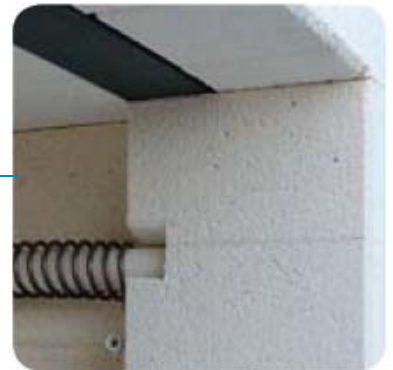
ReSiC подвеска свода - System "ROHDE"
